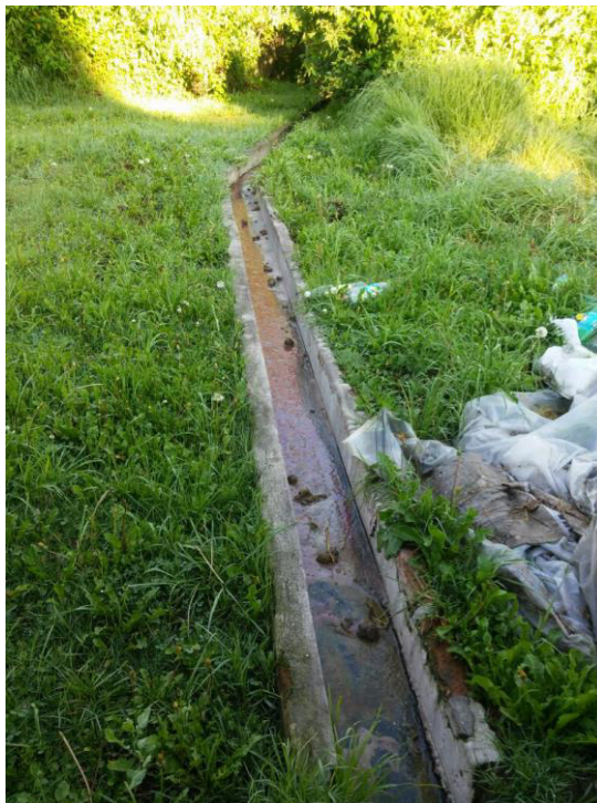
Figura 4. Descarga directa de aguas residuales al río Santa Clara
